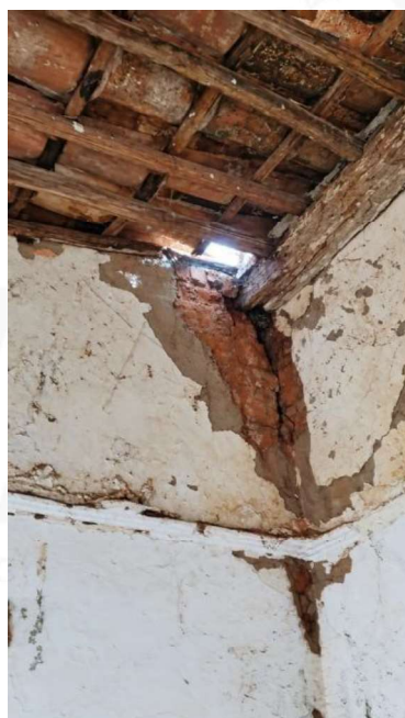
Figura 10 – Fissura no encontro de paredes com desagregação do adobe e abertura na cobertura
