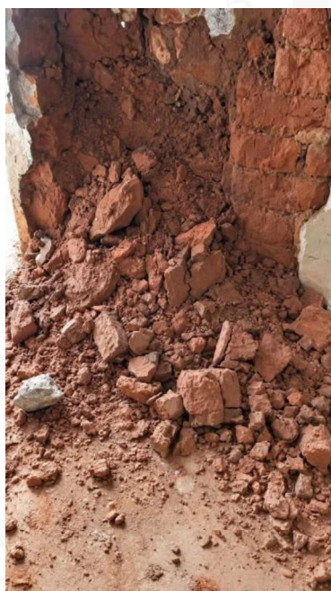
Figura 02 – Colapso parcial de trecho de alvenaria de adobe, com material desagregado no piso
