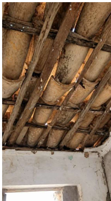
Figura 05 – Telhamento cerâmico com frestas e pontos de entrada de luz e água
