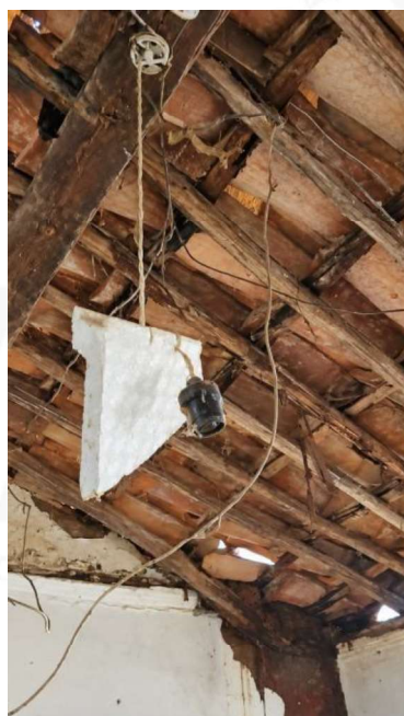
Figura 06 – Cobertura com peças de madeira degradadas, telhas deslocadas e ponto de luz improvisado
