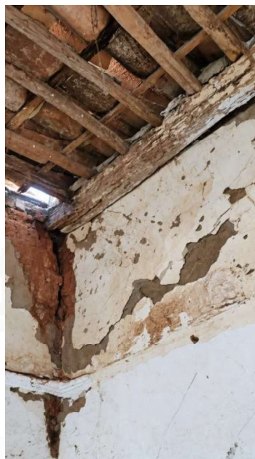
Figura 09 – Canto com adobe exposto, fissuração e cobertura aberta
