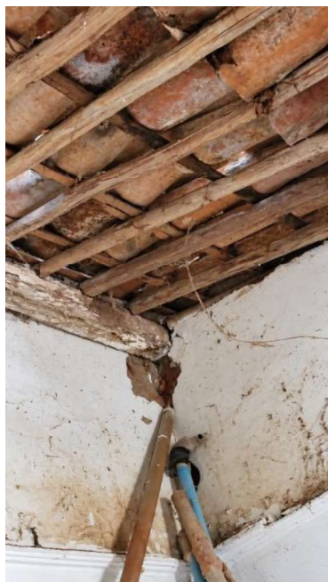
Figura 08 – Deterioração no encontro entre parede e cobertura e tubulações aparentes
