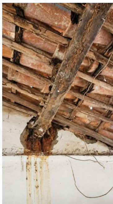
Figura 07 – Extremidade de viga degradada no apoio sobre a alvenaria, com escorrimentos na parede
