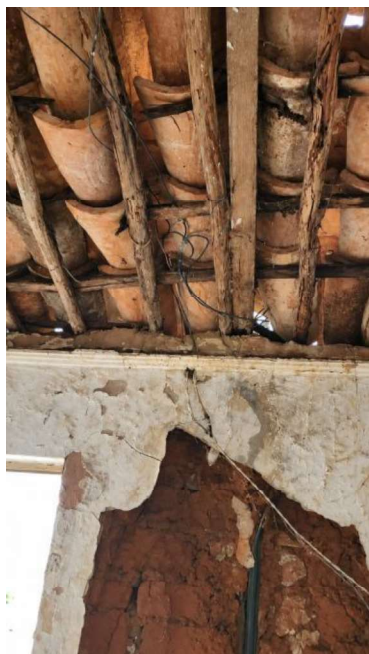
Figura 04 – Estrutura de madeira deteriorada, fiação aparente e perda de revestimento sobre vão
